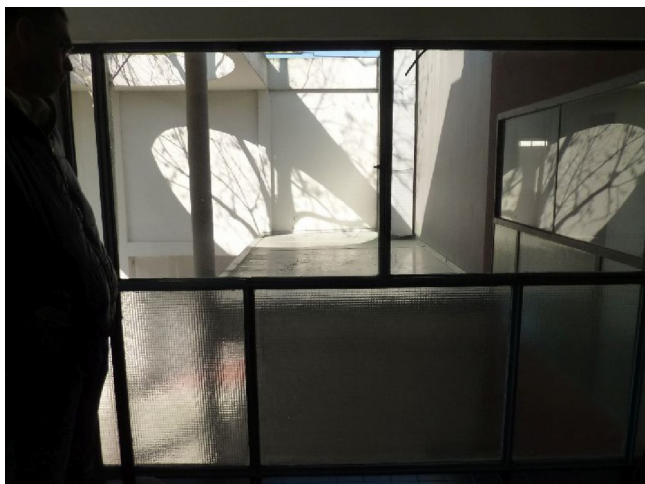
Foto n. 2 - Vetrata non protetta al piano primo
